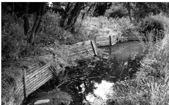
Zcela nevyhovující revitalizační objekt – tzv. stabilizovaný výmol. Snaha rozčlenit upravené koryto tůň tu byla poznamenána zbytečnou obavou projektanta z neopevněných břehů. Objekt vzhledem připomíná válečný zákop, po roce je tůň plná usazenin a po několika letech se odřevěné boky bortí, „předprseň“ vytvořená z vyhrnuté zeminy se začíná sesouvat zpět do koryta. Pracnost a pořizovací náklady jsou vzhledem k malé užitné hodnotě objektu značné
